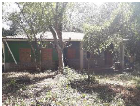
Figura 9. Centro de Interpretación del ANP Los Farallones, se evidencia la falta de insumos y mantenimiento.
